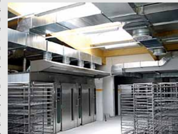
Klima- und Filteranlage in einer Großbäckerei
